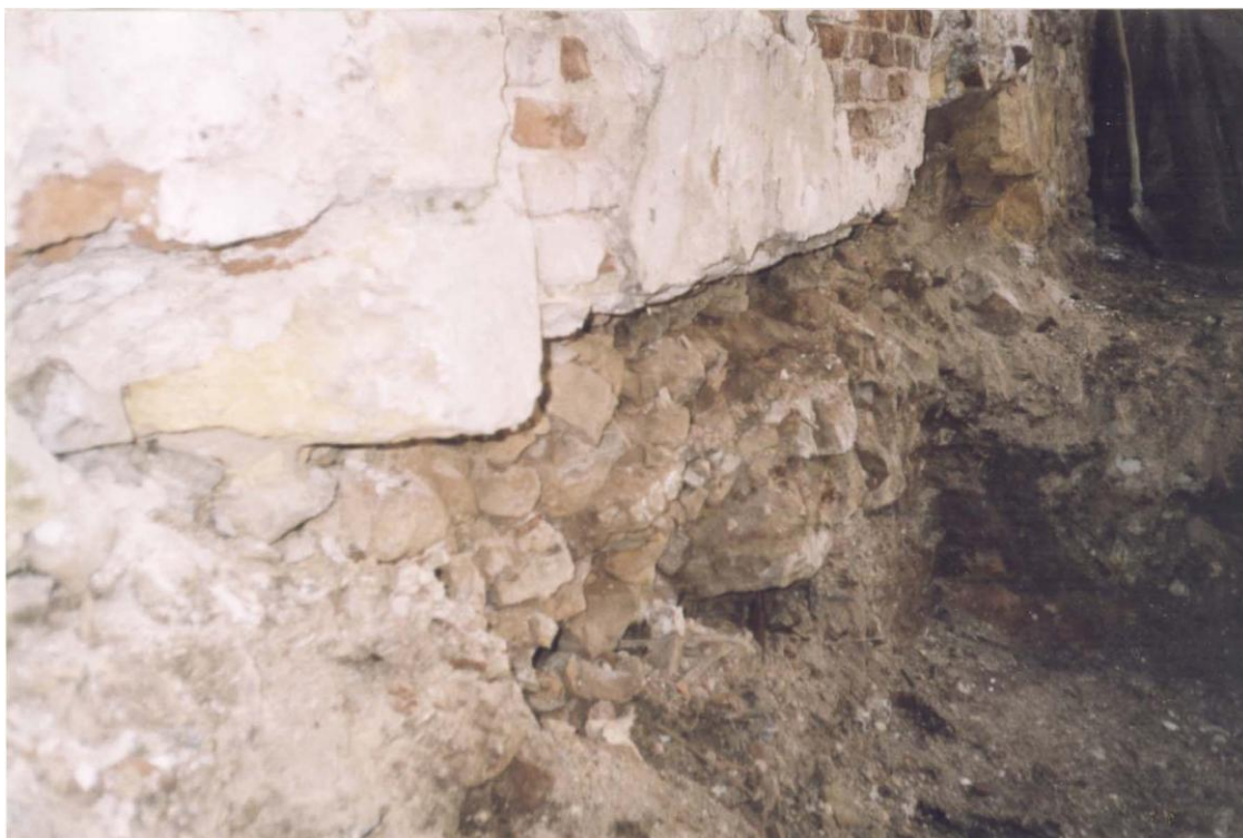
Фото 7. Состояние фундаментов трапезной Никольской церкви. Бутовая наброска выполнена без связующего раствора, пустоты между камнями заполнены природным грунтом.
